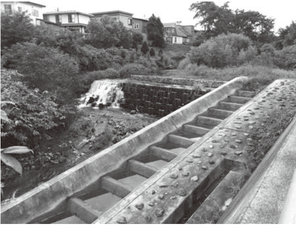
図8-3 渇水時に魚道が通水しない神山落差工
