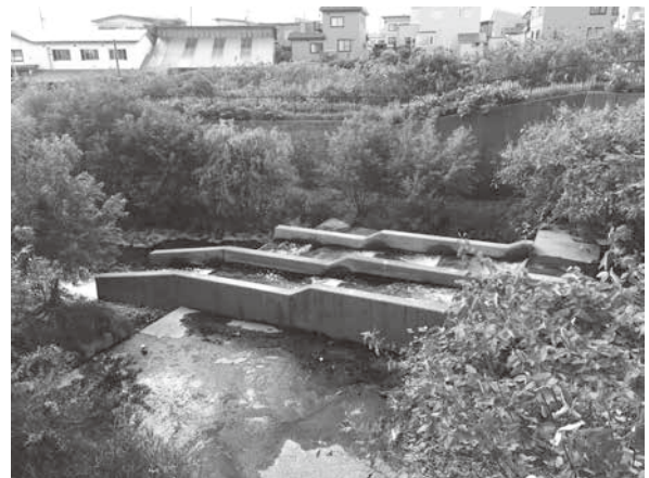
図8-1 魚道のある中道橋上流落差工
